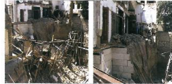
گودبرداری غیر اصولی و تخریب بنای مجاور گود
